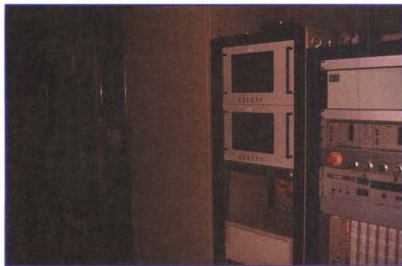
Parte delle attrezzature elettroniche di gestione della macchina "costruisci CD", in particolare il pannello dell'energia elettrica e i display di controllo del corretto funzionamento.
